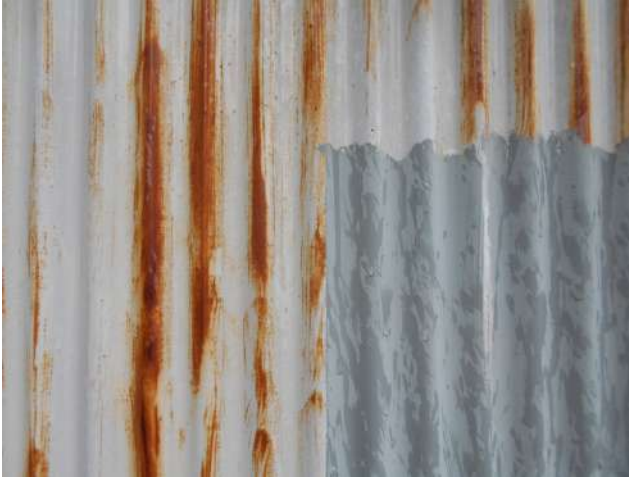
金属製の外装材 錆の上から塗装
